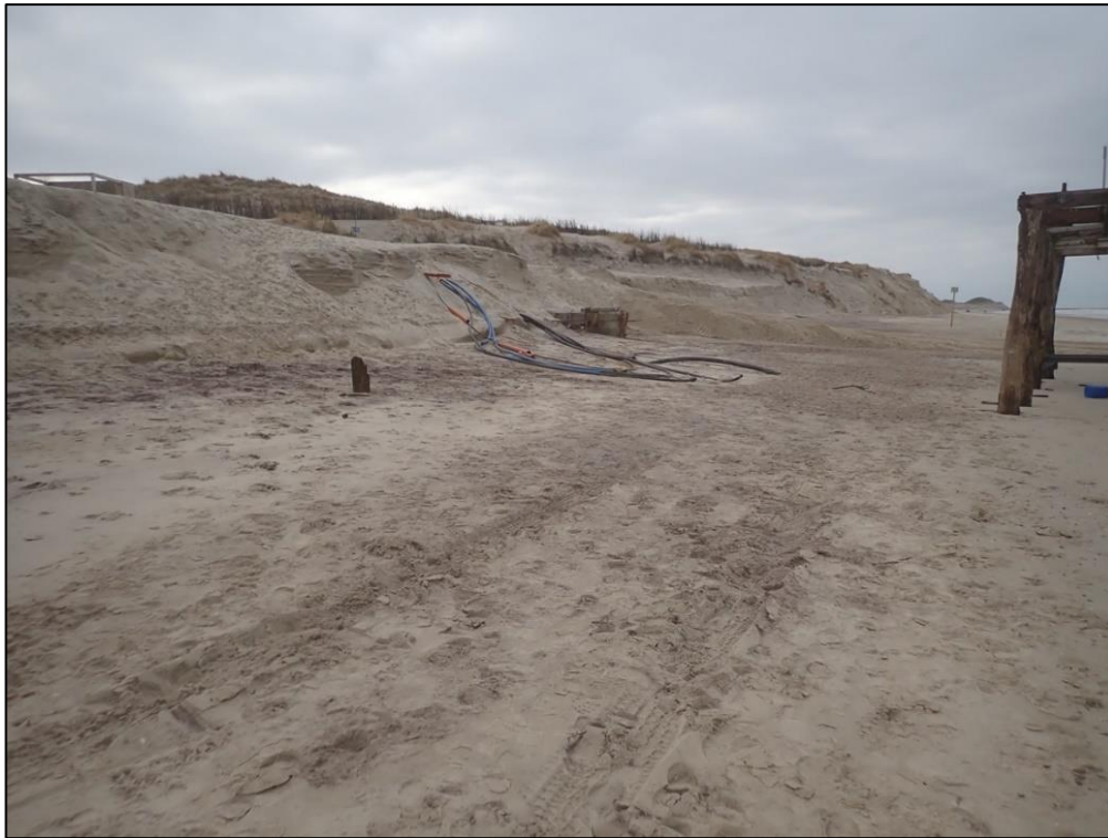
Abbildung 3: Freigespülte Versorgungsleitungen zur Außengastronomie
